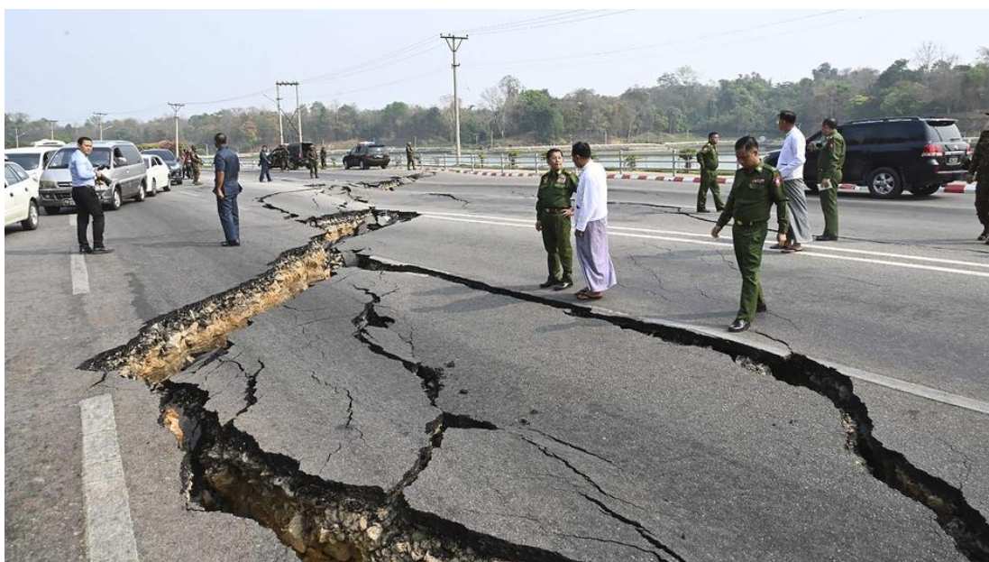
Figura 6.10. Daños en carreteras de Myanmar debidos al sismo.
