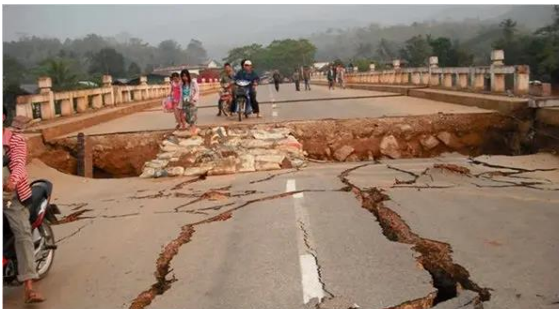
Figura 6.12. Daños en carreteras de Myanmar debidos al sismo.
