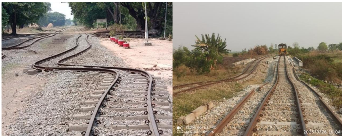
Figura 6.15. Deformaciones de vías en el sistema ferroviario de Myanmar a consecuencia del sismo.
