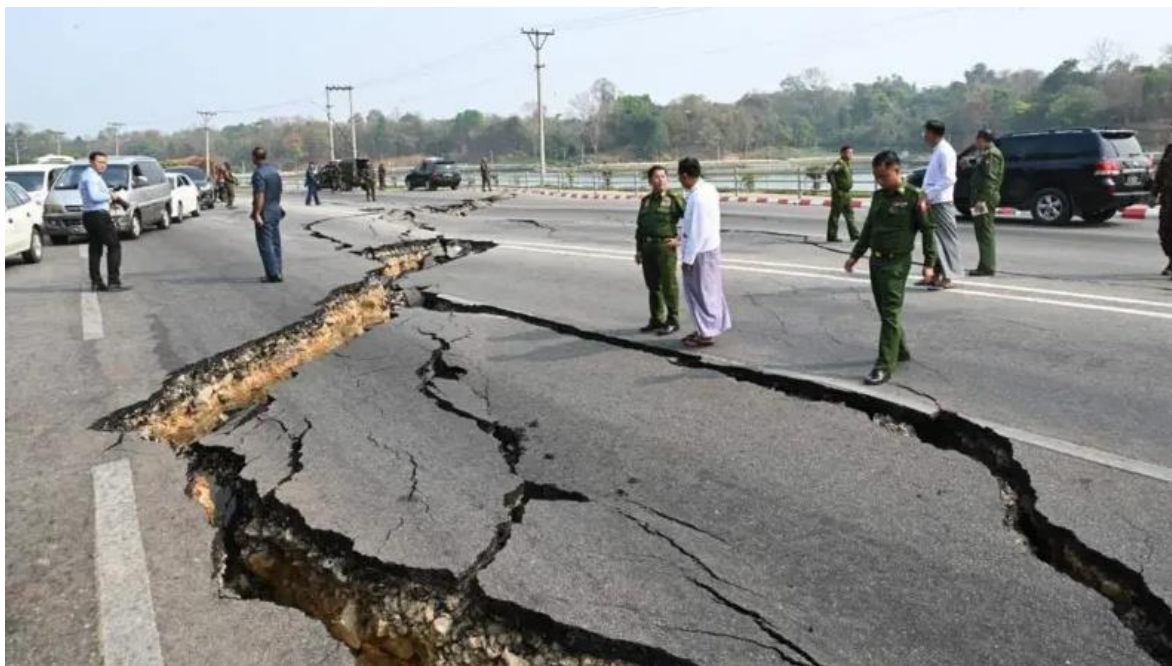
Figura 3.17. Carretera agrietada captado en la capital de Myanmar (BBC, 2025) ( https://rapidmapping.emergency.copernicus.eu/EMSR798/reporting )
