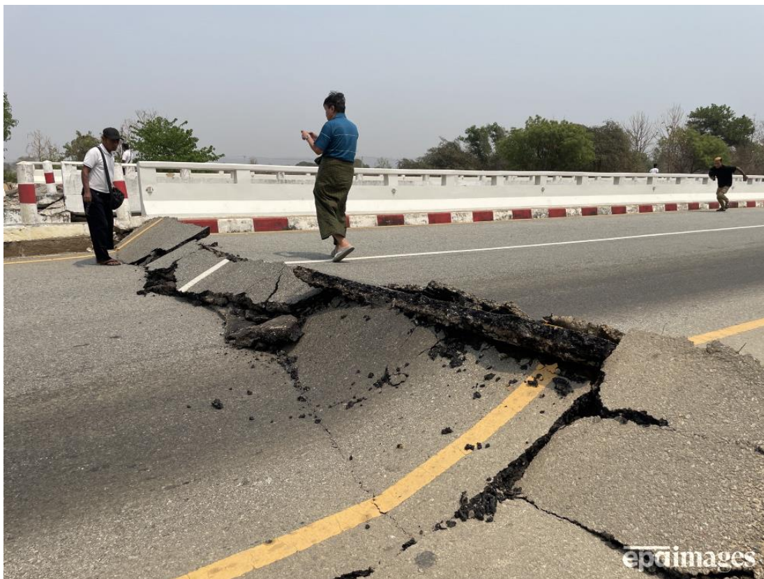
Figura 6.11. Daños en carreteras de Myanmar debidos al sismo.
