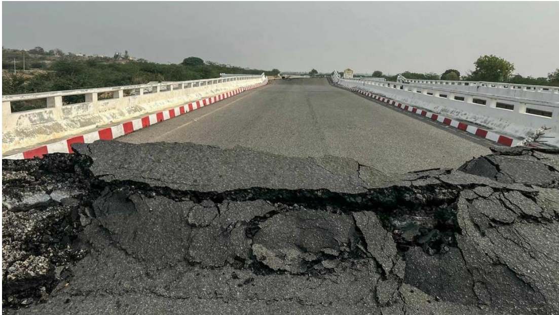
Figura 6.9. Daños en carreteras de Myanmar debidos al sismo.
