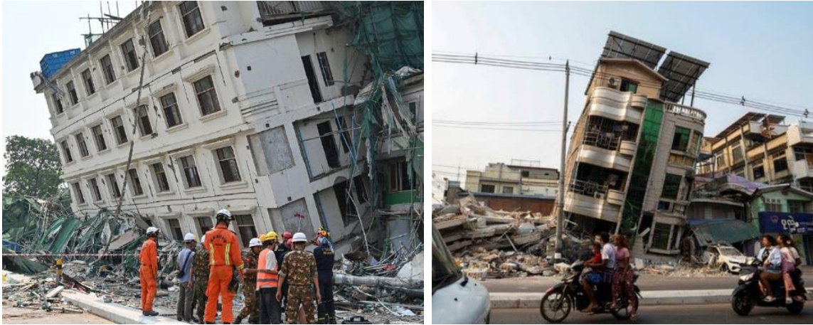
Figura 3.12. Edificios colapsados por posible licuación del suelo
