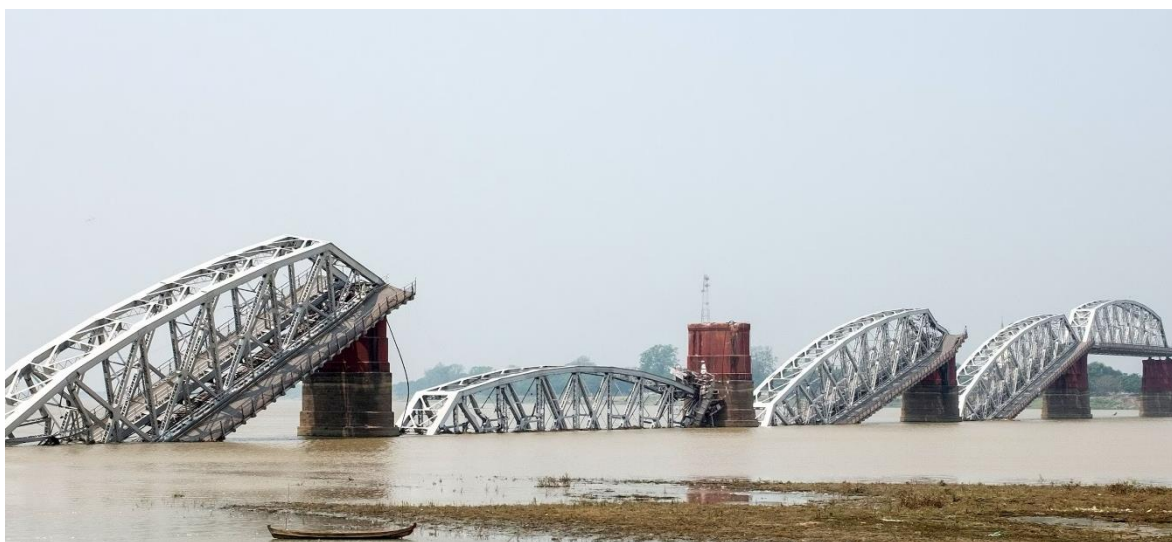
Figura 6.2. Puente Ava después de colapsar debido al sismo de Myanmar.
