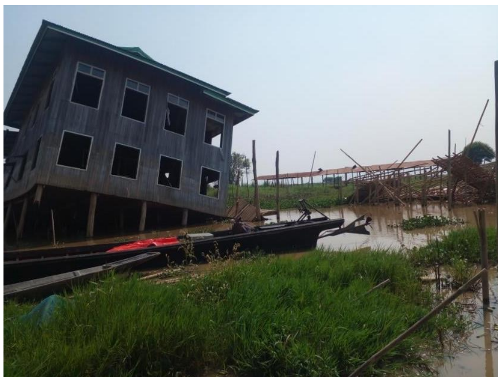
Figura 3.10. Licuación del suelo en un edificio desplantado en un depósito totalmente saturado ( https://www.facebook.com/photo?fbid=1028577946036478&set=pcb.1028578072703132 )
