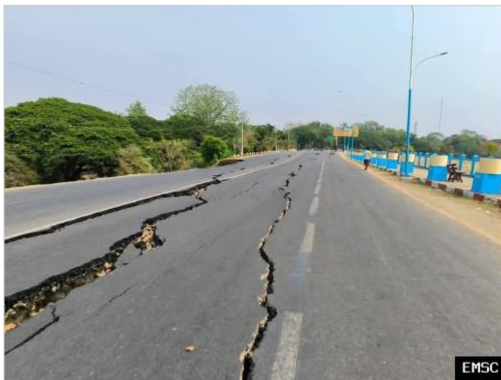
Figura 3.16. Deslizamiento en carretera a 123 km del epicentro, Meiktila, Myanmar ( https://emsc.eu/Special_reports/?id=352 )
