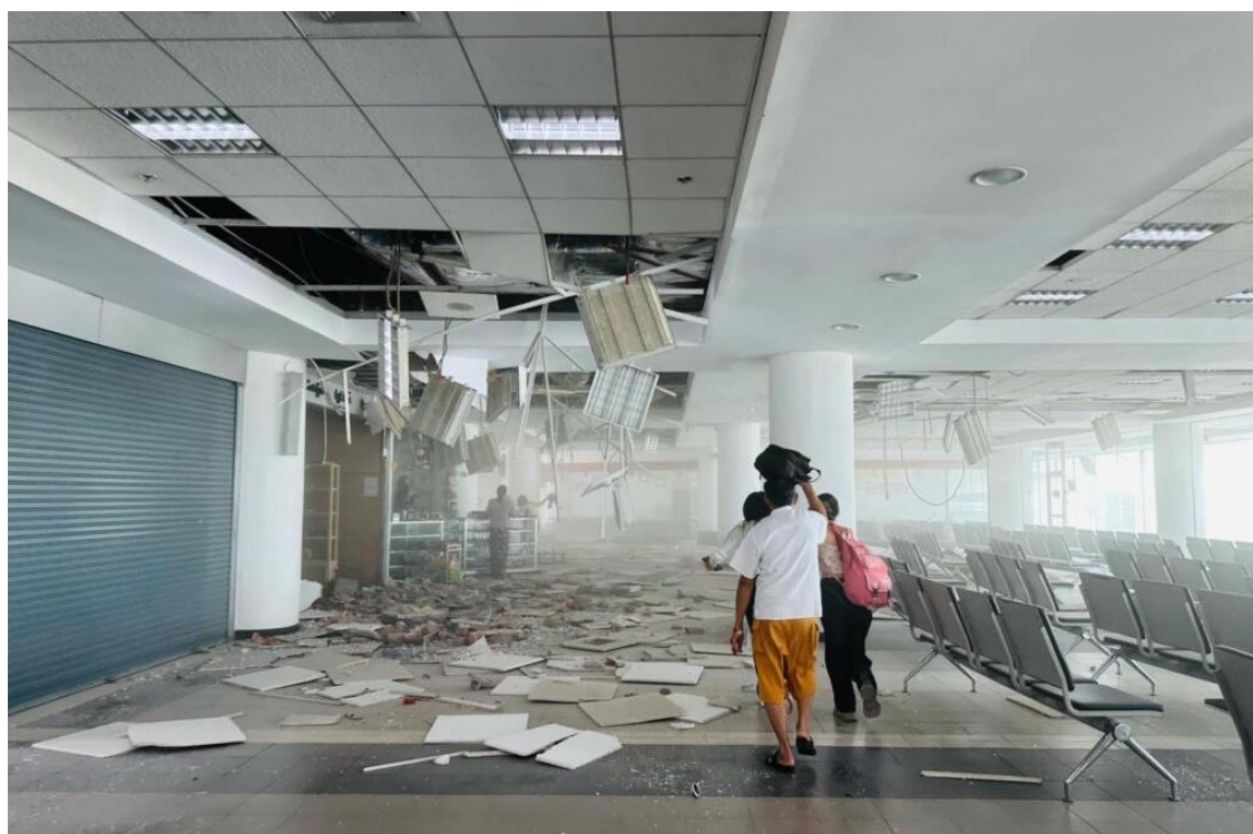
Figura 6.14. Daños en la Terminal del Aeropuerto Internacional de Mandalay.
